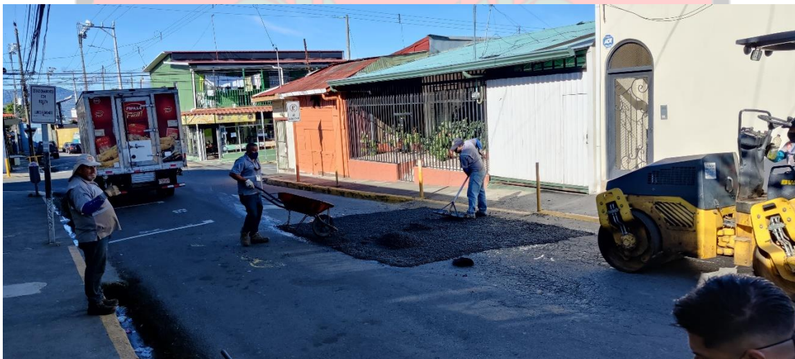
Imagen 8: bacheo menor en avenida 1.
