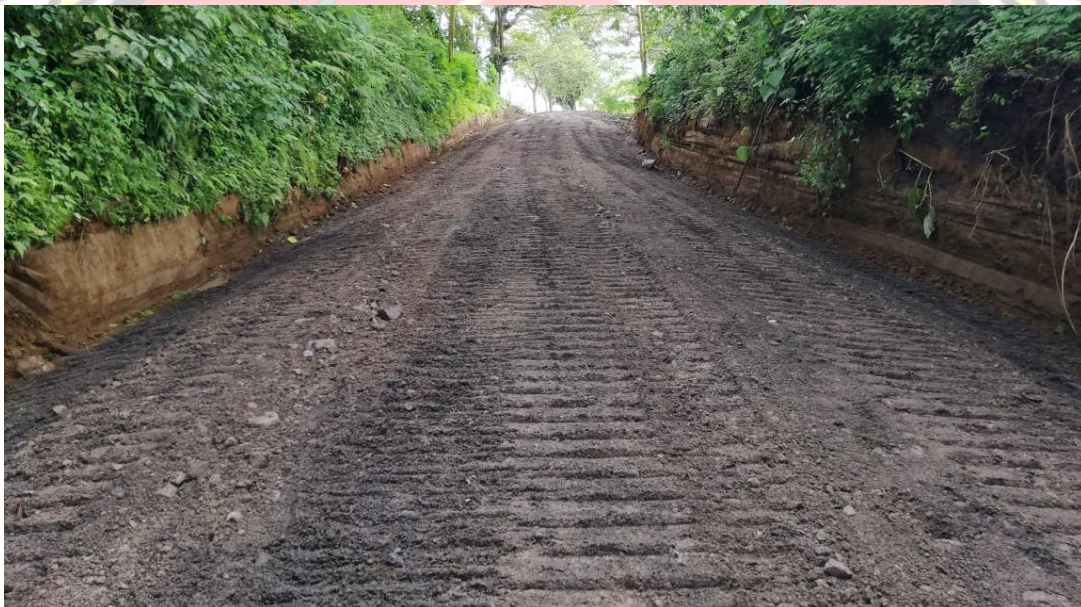
Imagen 13: Rehabilitación con material de perfilado de derecho de vía de Calle La Isla a Rancho Redondo, calle La Torre.
