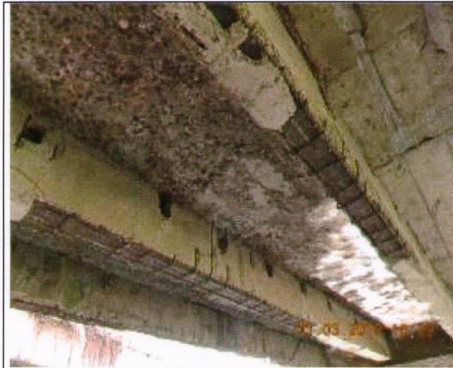
Las vigas principales tienen el acero de refuerzo expuesto y con un alto grado de corrosión. La extensión del daño es severa.
