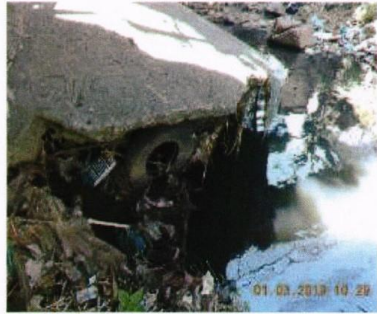
La fundación del bastión-Este aparenta contar con una estructura de protección contra la socavación del bastión, la cual presenta socavación.
