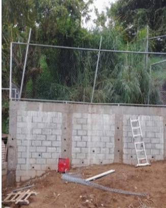
Malla perimetral en la escuela Juan Flores Umaña
